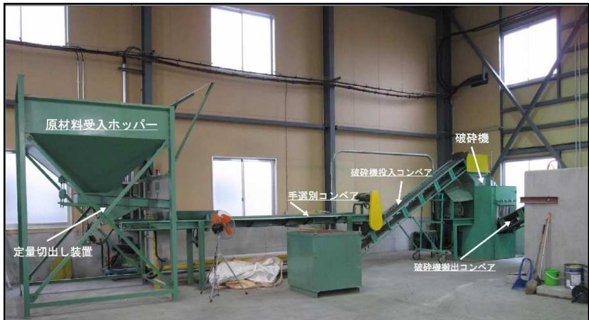
図-1 廃棄ピン類破砕施設処理工程
