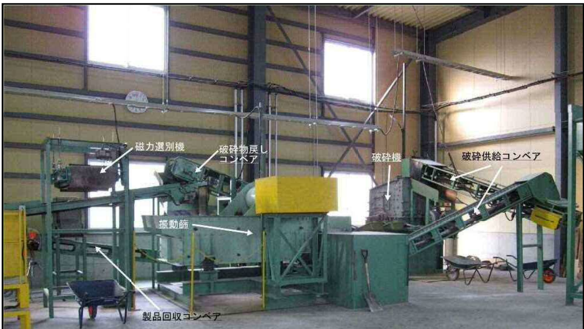
図-2 建材板ガラス等破碎施設処理工程
